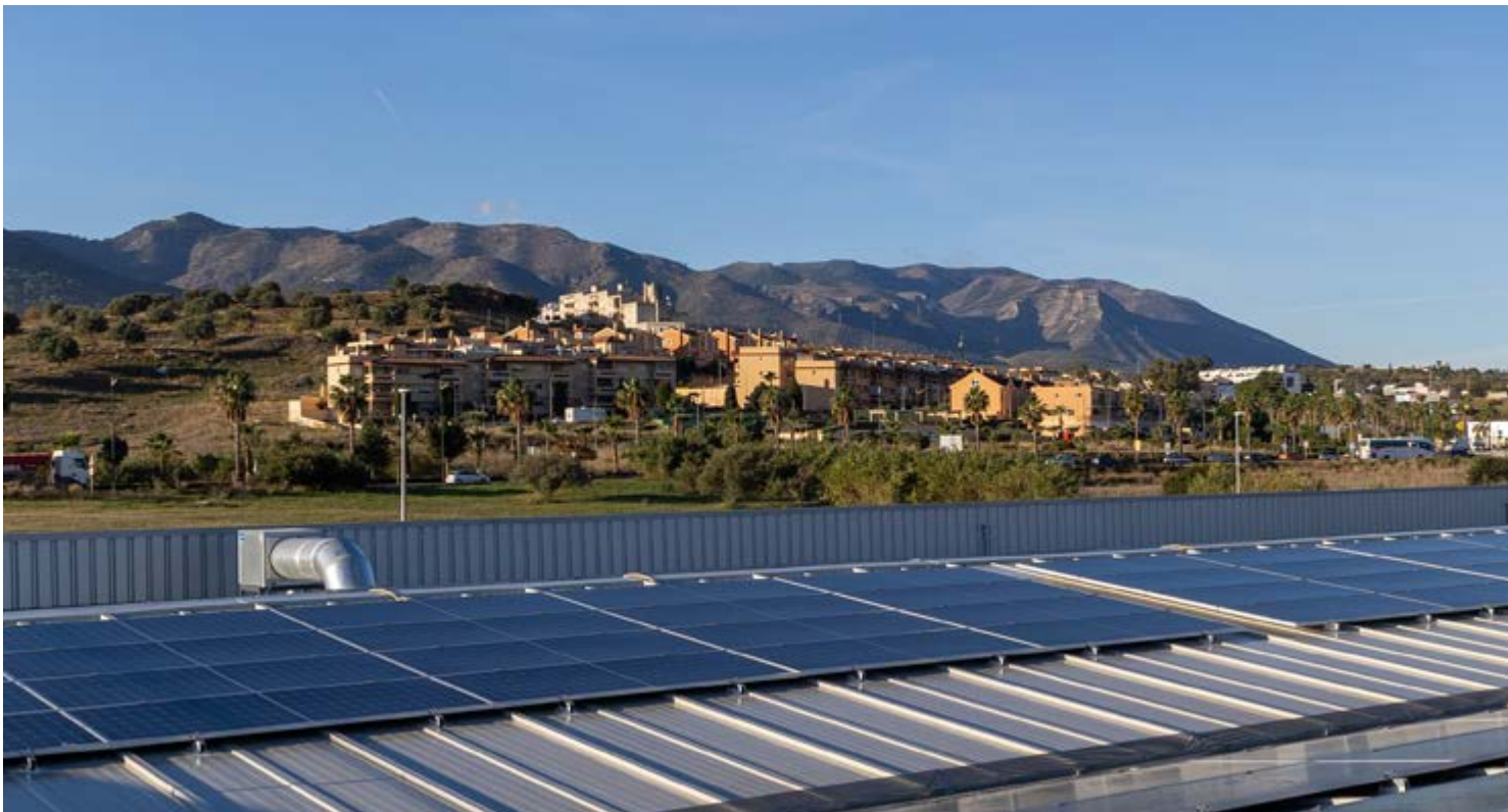
Paneles solares instalados en el supermercado de Santo Domingo en El Ejido, Almería.
