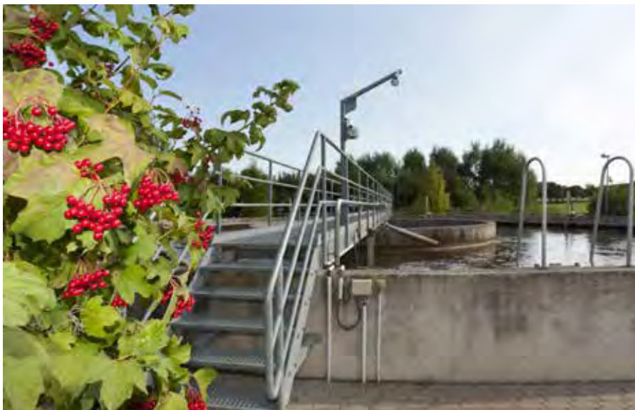
Kläranlage Beendorf | Foto: AZV „Aller-Ohre“
